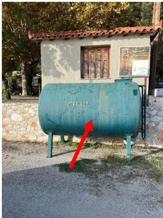
Εικόνα 2: Υφιστάμενη μεταλλική δεξαμενή πετρελαιοειδών αποβλήτων 5m 3 στο βόρειο τμήμα του λιμένα Λουτρακίου
