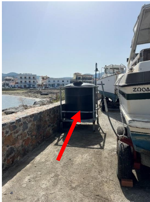
Εικόνα 1: Υφιστάμενη πλαστική δεξαμενή πετρελαιοειδών αποβλήτων 2\text{m}^3 στο νότιο τμήμα του λιμένα Σκοπέλου
