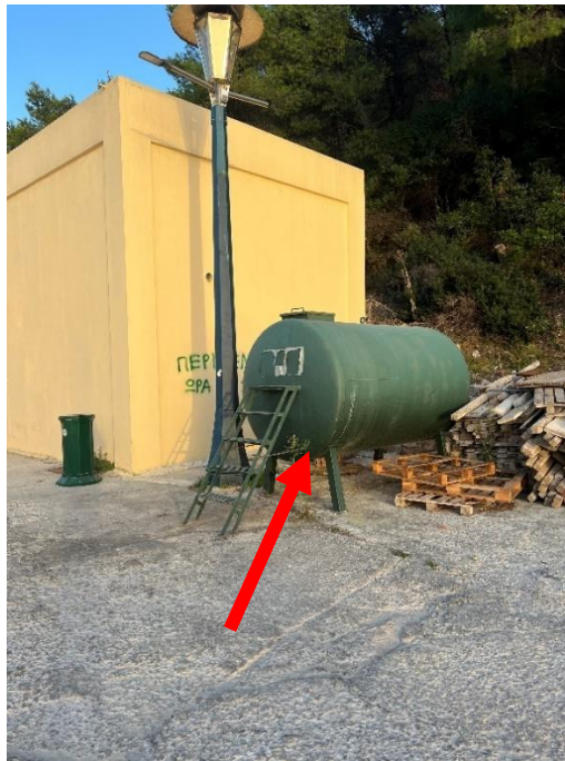
Εικόνα 3: Υφιστάμενη μεταλλική δεξαμενή πετρελαιοειδών αποβλήτων 5m 3 στο νοτιοδυτικό τμήμα του λιμένα Αγνώντα
